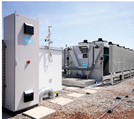
Adiabatischer Rückkühler mit FU-geregelten Ventilatoren und einzeln angesteuerten Kugelhähnen zur Besprühung der Wärmetauscher.
